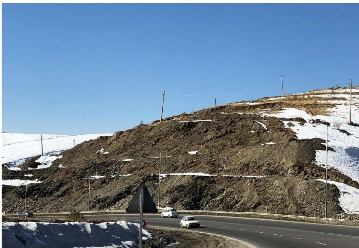
شکل ۱-۱۶۲: توپوگرافی ملایم منطقه مورد مطالعه و احداث ترانشه با شیب تند در اطراف جاده کیلومتر ۴۵۰+۶ تا ۶۰۰+۶ سمت اسدآباد
