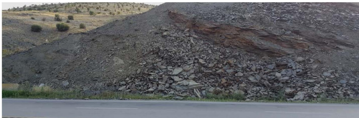
شکل ۱-۱۶۵: نمونه‌هایی از وقوع پس گسیختگی‌های متعدد پس از عملیات تعریض در مسیر مورد مطالعه از ابتدای گردنه تا کیلومتر ۱+۶۰۰ از سمت اسدآباد
