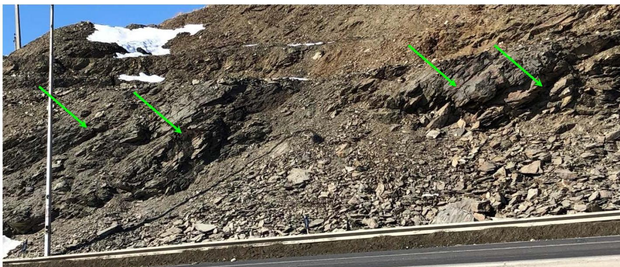
شکل ۱-۱۶۰: وجود پهنه‌های برشی متعدد در ساختگاه ترانشه مورد مطالعه و جهت یافتگی آنها به سمت جاده
