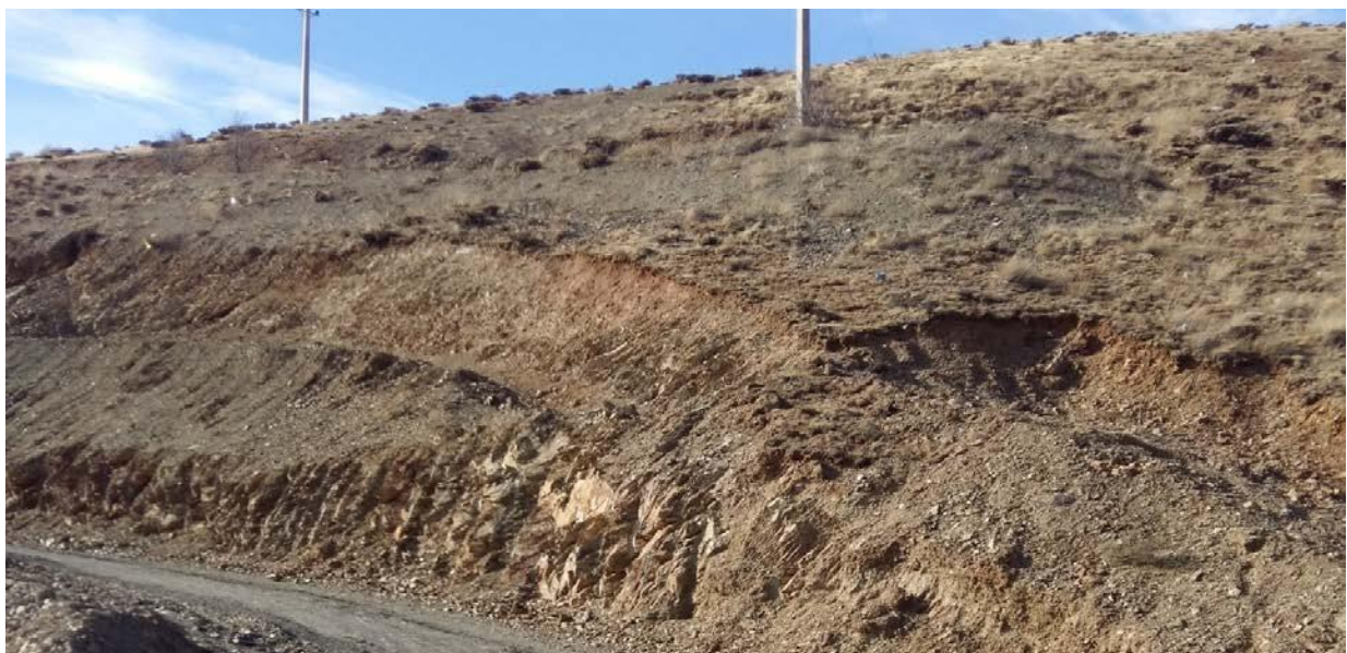
شکل ۱-۱۵۶: شیب ملایم منطقه و از بین رفتن لایه خاک سطحی در اثر احداث ترانشه‌های جدید
