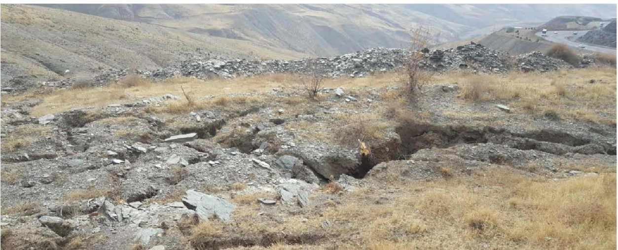
شکل ۱-۱۶۳: تشکیل گوه لغزش و ایجاد پس‌گسیختگی و ناپایداری‌های متعدد بر روی سطح ترانشه‌های احداث شده در کیلومتر ۶۴۵۰ تا ۶۶۰۰ از سمت اسدآباد
